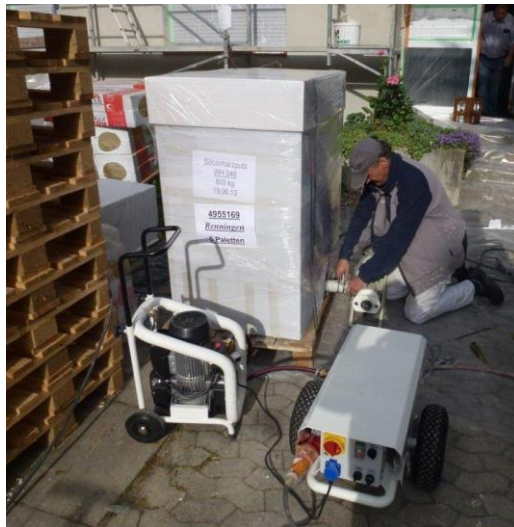
Logistische Lösungen wie der Sprinterservice oder die Putzverarbeitung aus dem Großgebäude – hier ein Cleverpack mit Förderpumpe für den Oberputz – unterstützen die schnelle und unkomplizierte Ausführung in Renningen. (Foto: Knauf)
