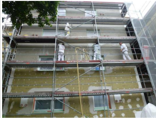
Zügiges Arbeiten mit vier Mann auf dem Gerüst sowie der Spritztechnik für Kleber und Mörtel – hier beim Auftragen des Armierungsputzes. (Foto: Knauf)
